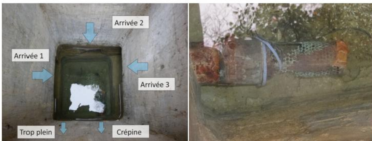
Figure 5 : Aperçu de la chambre de captage et de la crépine d'aspiration.
